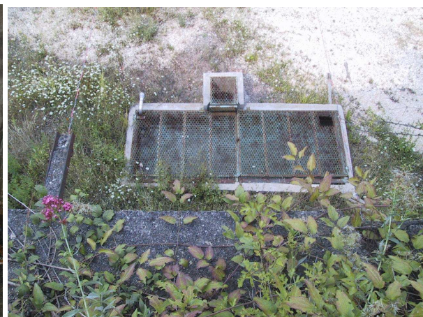
Grille de la ré injection des eaux des galeries de Silhol.
