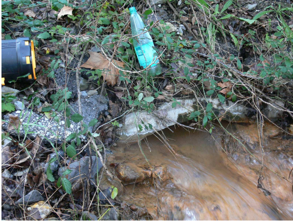
Détail de la sortie de la buse.
