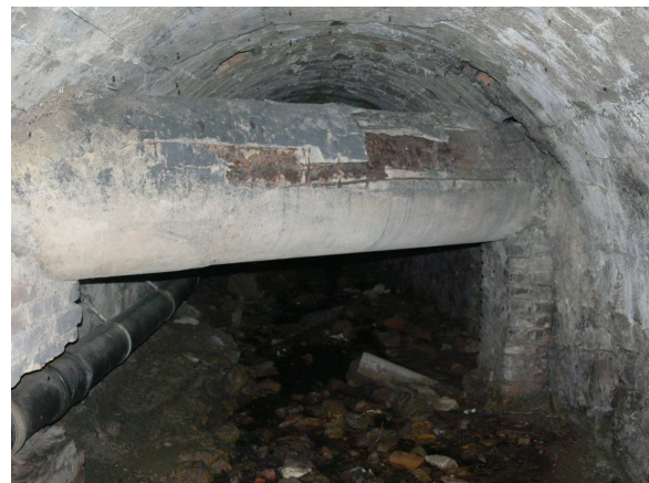
Grosse conduite: eaux galerie Silhol vers Silhol A?
