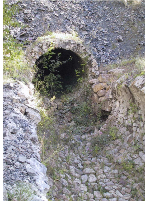
Détail montrant la partie détruite.
