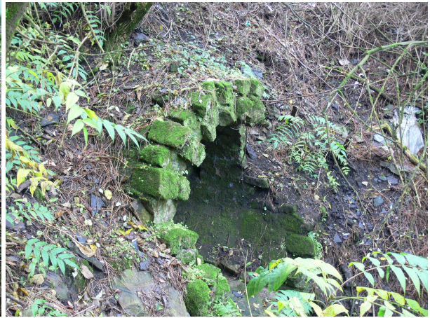
Détail de la sortie aval dégradée.
