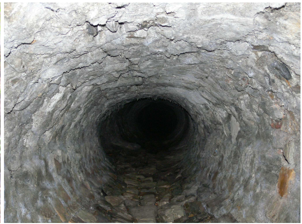
Ovalisation du tunnel par fissuration de la voûte.
